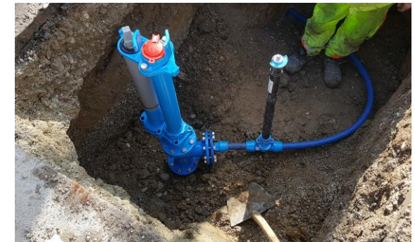
Wasserleitung mit Schieber
