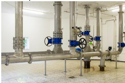
Rohrkeller im Wasserturm
